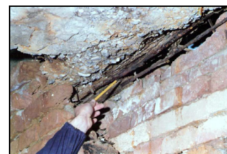
Fig. 6. Plancher technologique: dégradation complète du béton par corrosion dans la zone d'appui de la plaque sur le mur en maçonnerie; corrosion avancée des armatures, avec des réductions significatives de section.
