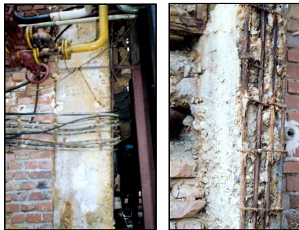
Fig. 3. Poteaux: dégradation en profondeur du béton par corrosion acide; corrosion avancée des armatures, avec réductions significatives de section/leur disparition sur certaines zones; armatures "flottantes".
