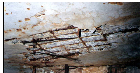
Fig. 5. Plancher technologique: fissuration et éclatement du béton d'enrobage; corrosion avancée des armatures, avec des réductions significatives de section, jusqu'à leur disparition.
