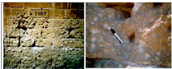
Fig.7 : Alvéolisation très intense dans le bas du mur est de la Tour Hassan.
