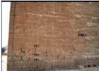
Fig.5 : façade Est de la Tour Hassan montrant la dégradation par remontée capillaire à la base du mur et le noircissement de la partie médiane et l'emplacement des échantillons TH1, TH3, TH4 et TH5.
