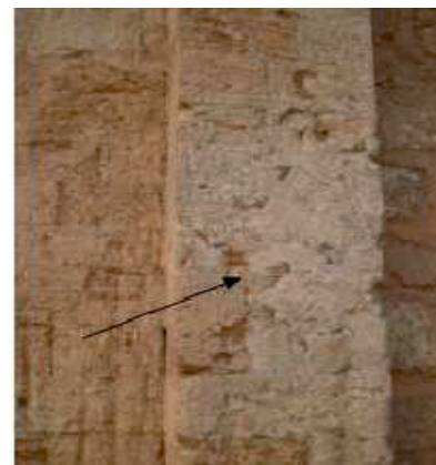
Fig.10 : Colmatage inapproprié des zones érodées par du ciment.
